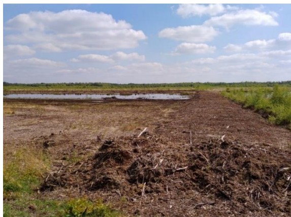
Abbildung 36: Verwallung zur Wiedervernässung einer Fläche im Goldenstedter Moor (Eigene Abbildung: LUP GmbH).
